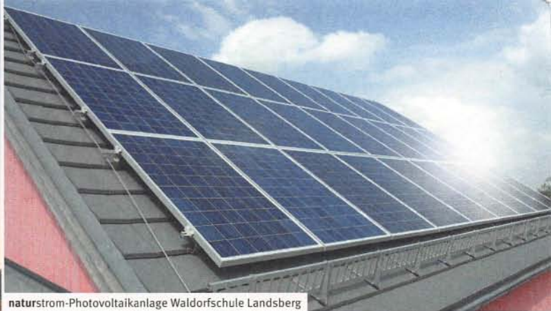
naturstrom-Photovoltaikanlage Waldorfschule Landsberg
